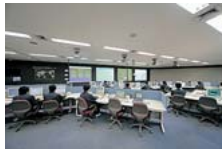
データセンター (統合管制センター)
